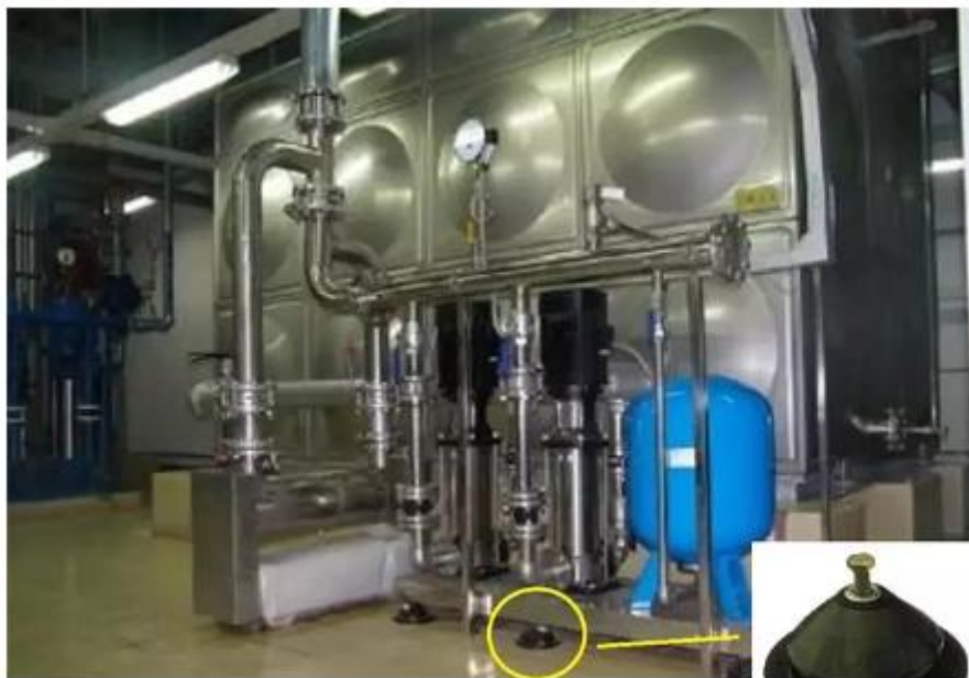
变频供水系统减振处理
