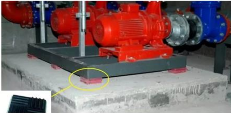
设备底部橡皮减震垫块设置
