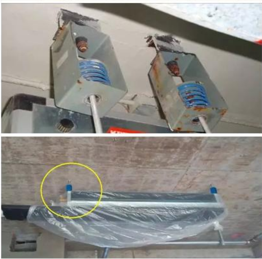
吊装式空调机组减振处理
