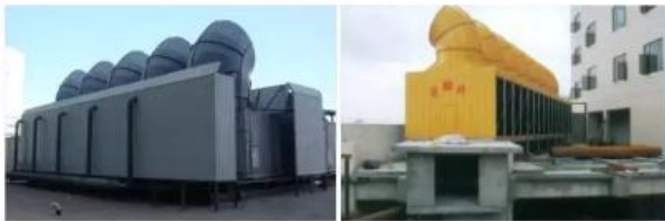
冷却塔消声处理
