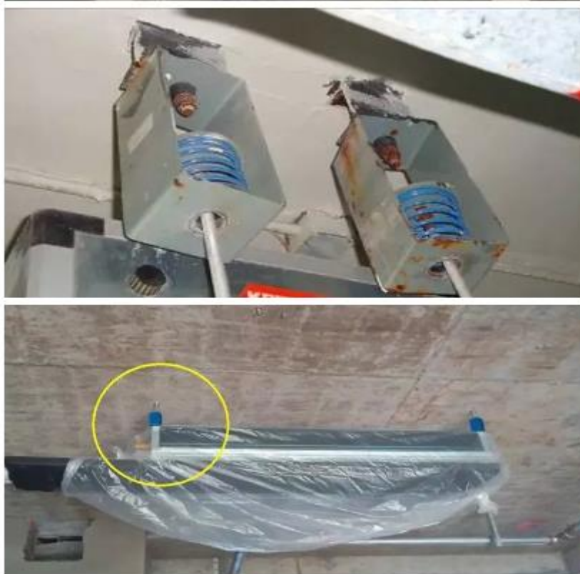
吊装式空调机组减振处理
