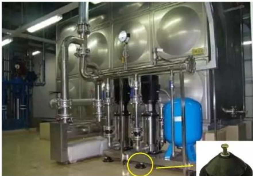
变频供水系统减振处理
