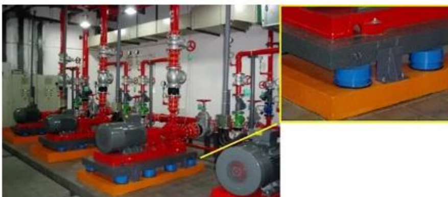
设置在设备底板两侧防位移的“靠山”
