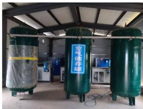
压缩空气机房
