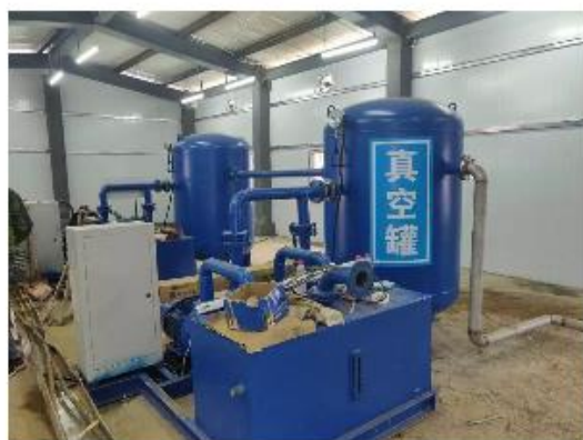
负压吸引气机房
