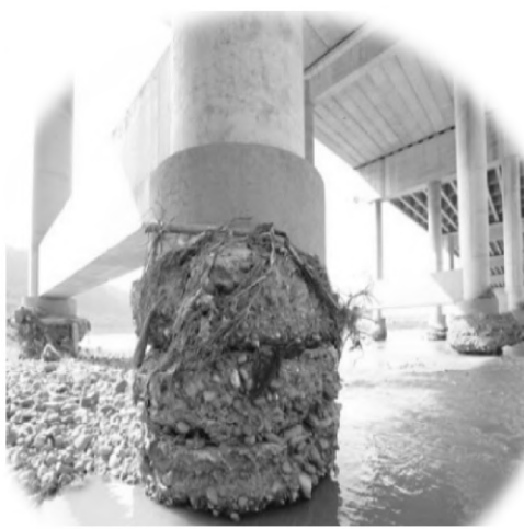
(b) 混凝土脱落、钢筋外露
