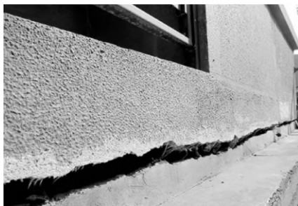
图 1-12 地基不均匀沉降导致建筑物裂缝
