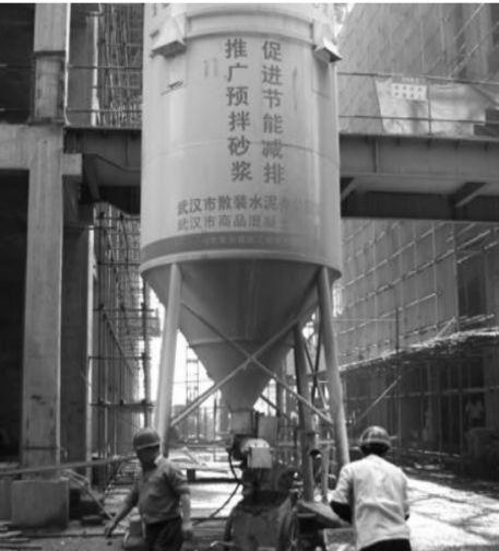
图 3-25 预拌砂浆储存罐
