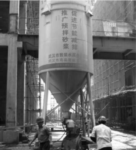
图 3-25 预拌砂浆储存罐
