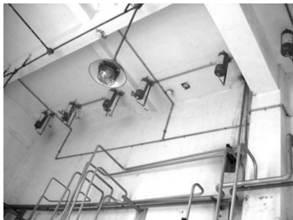
图 3-26 干粉灭火系统实景图
