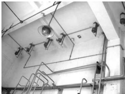
图 3-26 干粉灭火系统实景图
