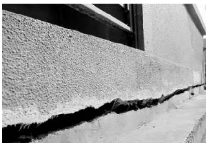
图 1-12 地基不均匀沉降导致建筑物裂缝
