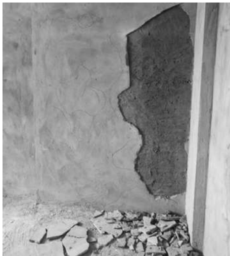
图 3-33 抹灰层呈空鼓、开裂状
