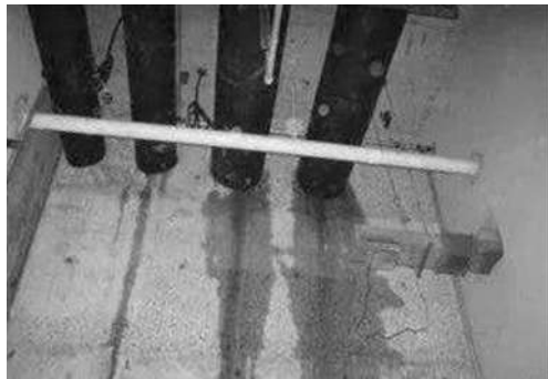
图 3-31 管道穿墙(地)部位渗漏水
