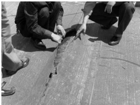
图3-29 卷材屋面开裂
