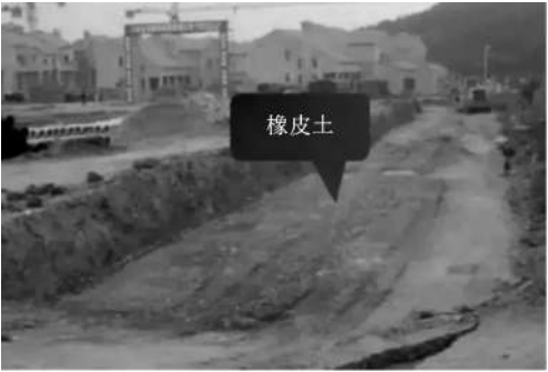
图 3-5 换土夯实中出现橡皮土
