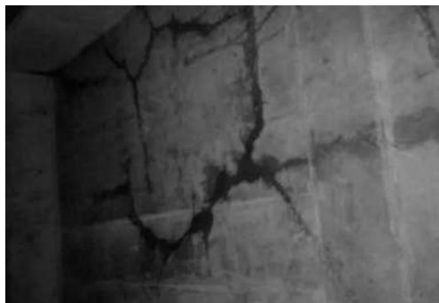
图 3-30 防水混凝土裂缝渗漏水
