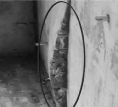
图 3-18 混凝土结构跑模、胀模后出现严重变形
