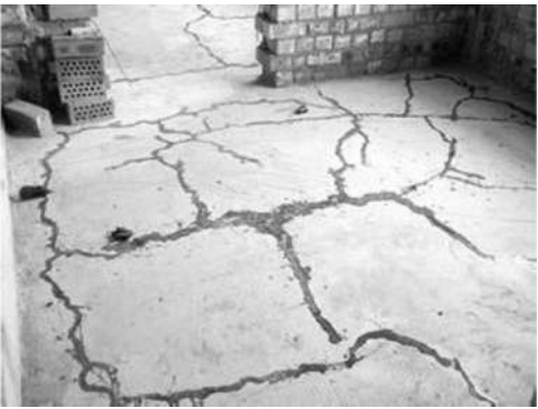
图 3-23 混凝土收缩裂缝
