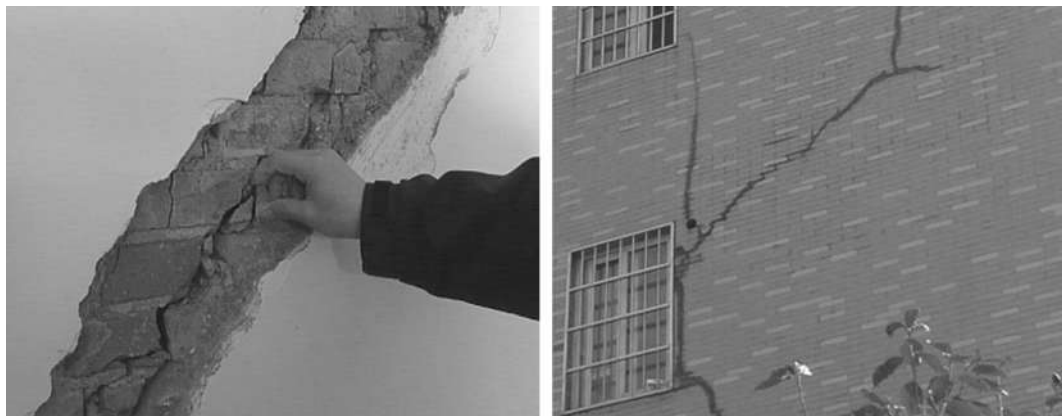
图 3-26 地基不均匀下沉引起墙体裂缝
