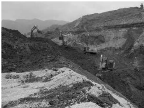
图 3-3 边坡局部或大面积塌方
