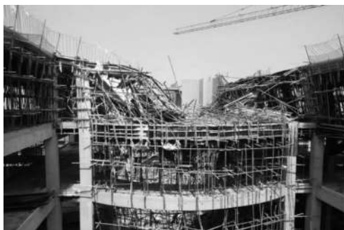
图 3-19 模板支架体系失稳坍塌
