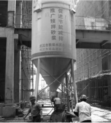
图 3-25 预拌砂浆储存罐
