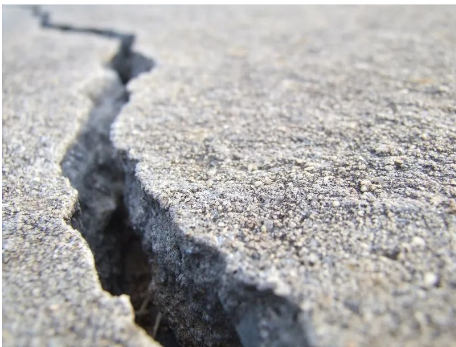
路面隆起与开裂
