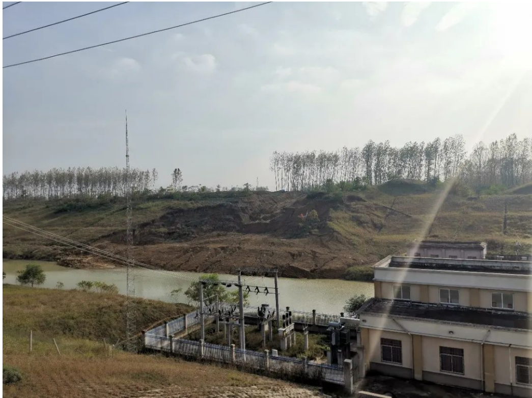
膨胀土滑坡（2020年5月，安徽合肥淠史杭灌区发生膨胀土滑坡）
